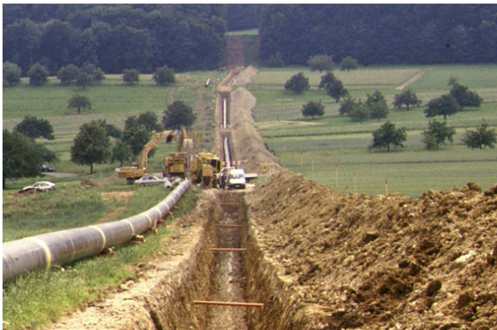
Fig. 2 > La fouille est excavée – Conduite de gaz Transitgas de Walbach (AG) à Däniken (SO) en 1994
